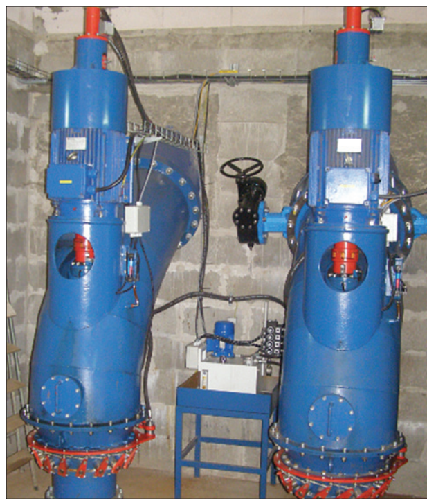
Nové MVE i nejmenších výkonů využívají nejmodernější dosažitelnou technologii.
