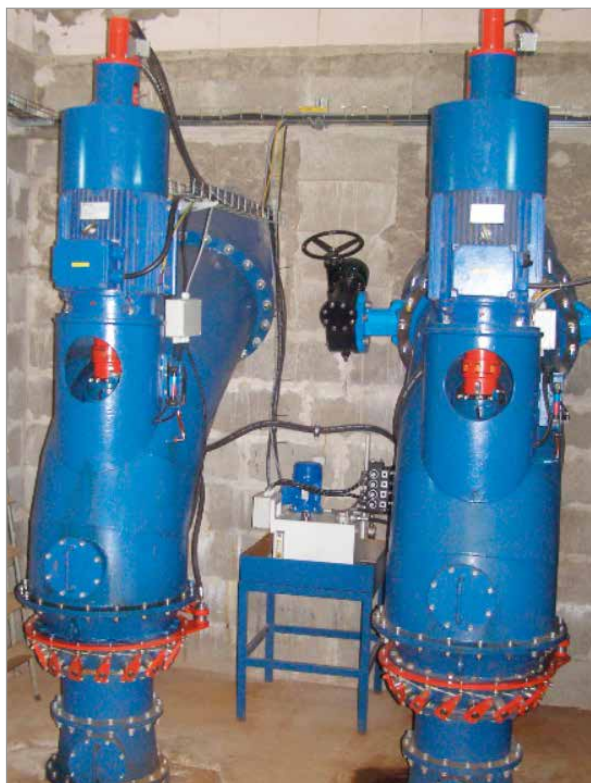
Kaplanovy turbíny dnes vyrábí elektřinu i v těch nejmenších MVE
