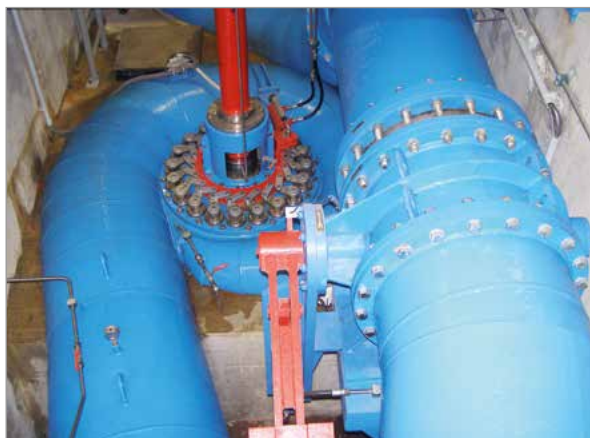
Výkonné turbíny provozují například státní podniky Povodí či ČEZ
