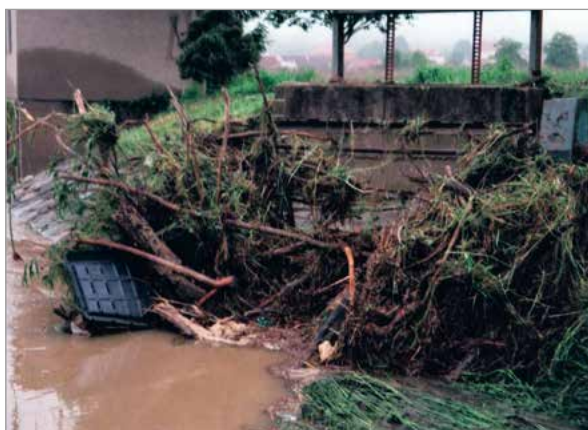
MVE svým provozem čistí vodní toky od plovoucích nečistot
